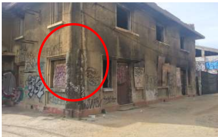
IMAGEN 21 Imagen propia daños estructurales de la maestranza
