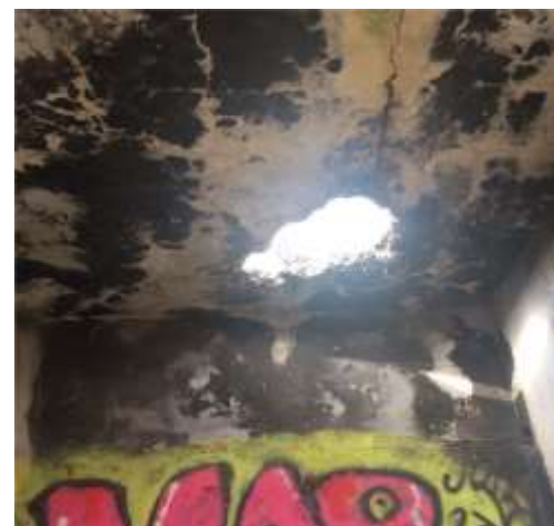
IMAGEN 23 Imagen propia daños estructurales de la maestranza
