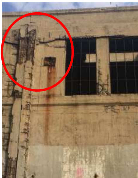
IMAGEN 20 Imagen propia daños estructurales de la maestranza
