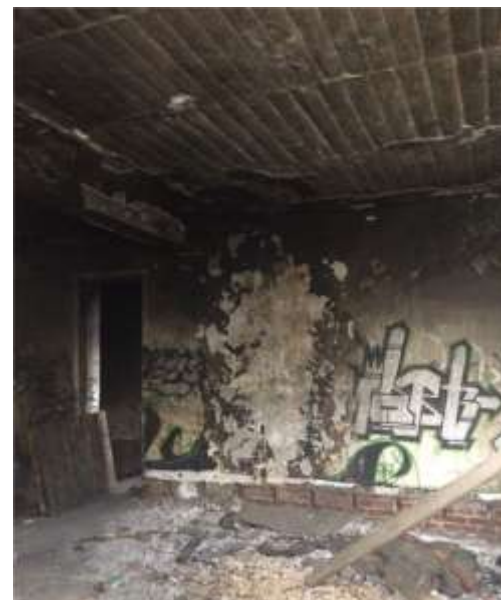
IMAGEN 22 Imagen propia daños estructurales de la maestranza
